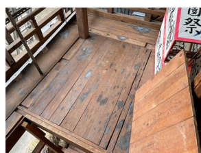
床板(修理前・2の山)
